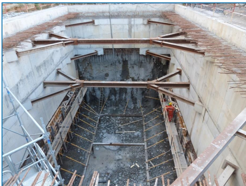
Figura 28 – Preparação da frente de ataque no interior do poço para as escavações subterrâneas do acesso Norte
